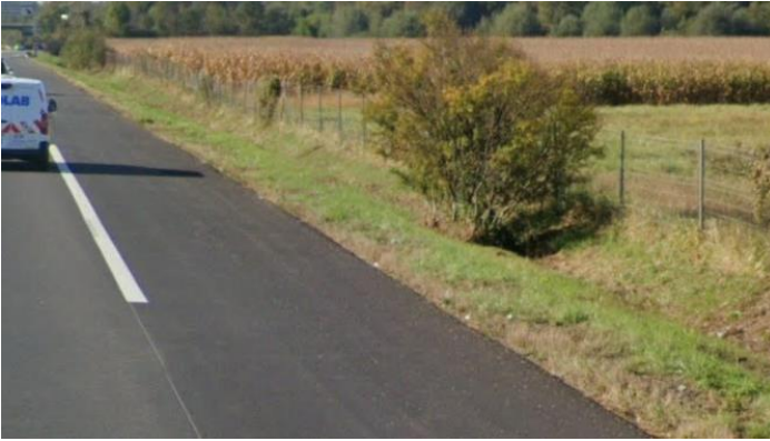
Figure 49 : Pas d'obstacle ou de dispositif de retenue (Source : Google Maps)
