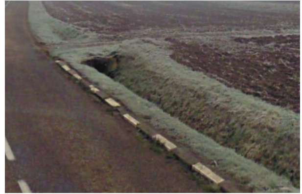
Figure 50 : Fossé profond et buse agressive, constituant tous les deux un obstacle (Source : Google Maps)
