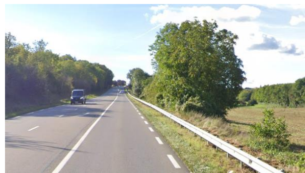
Figure 88 : Marquages d'axe et de rive en état normal (Source : Google Maps)
