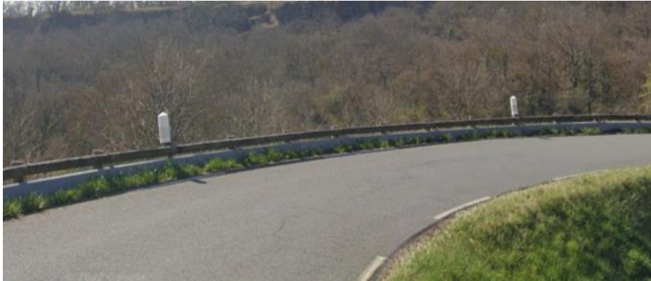
Figure 93 : Présence de SPM sous une glissière bois (Source : Google Maps)
