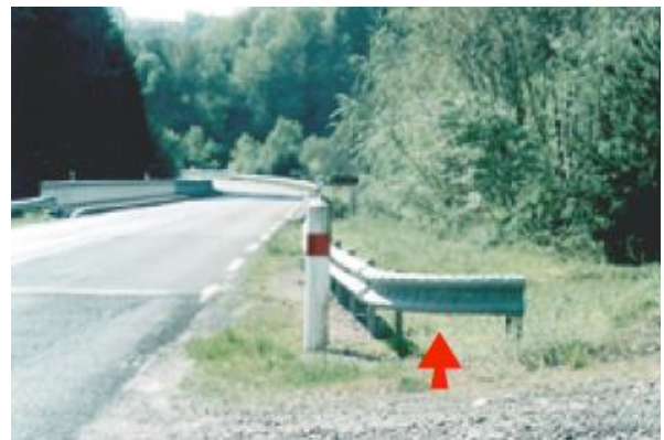
Figure 52 : Extrémité de dispositif de retenue constituant un obstacle (Source : Cerema)
